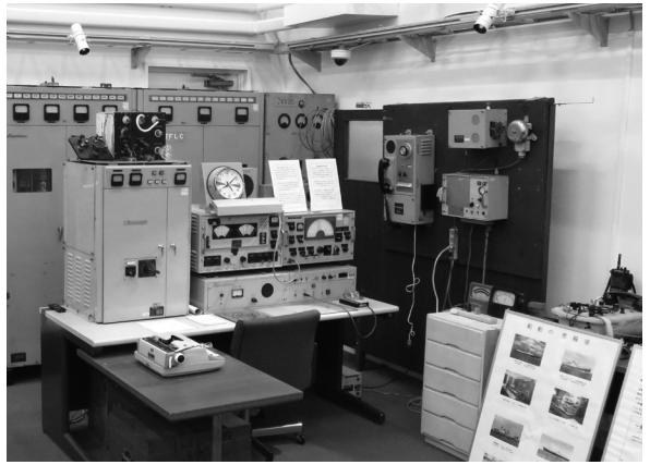
Zone2-2 船舶通信無線通信室
